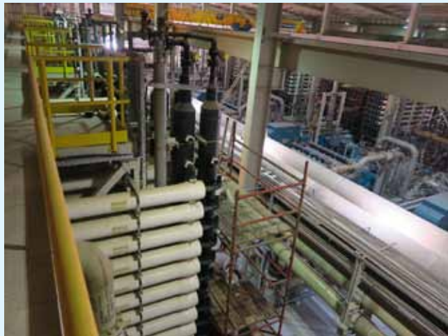
Ultrafiltration (UF) & RO Racks
